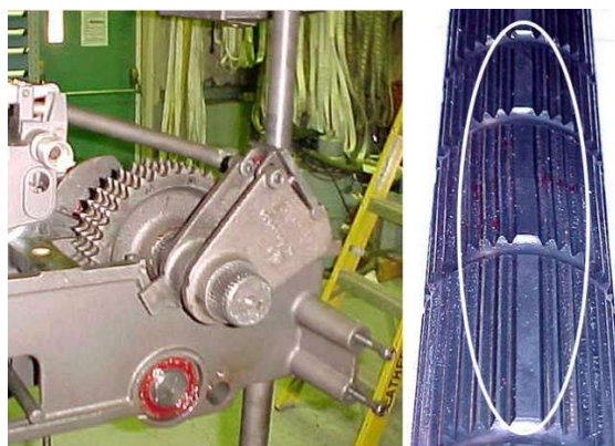
Figura 8 – Caso prático 3 – Eixo de comando do disjuntor distorcido
