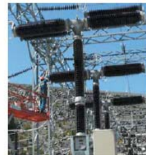
Fig 10 Interruptor automático de SF6 tipo HPL
